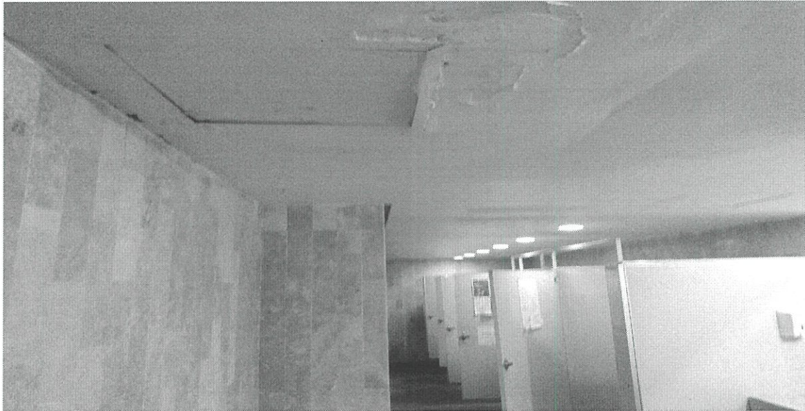
Plafón de sótano, dañado.
