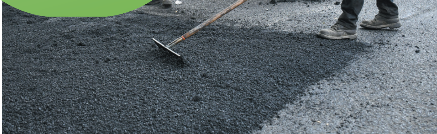
Las cuadrillas trabajan en las calles de las zonas más necesitadas con servicios de bacheo para una mejor movilidad.
