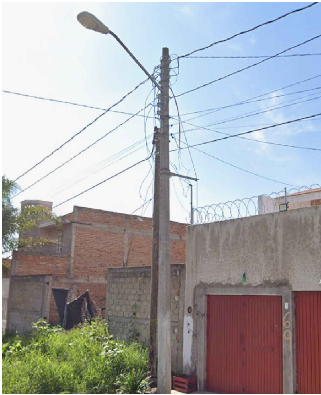
02 Poste 1 Poste a reubicar S/E
